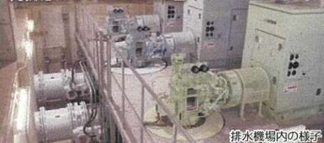
排水機場内の様子
